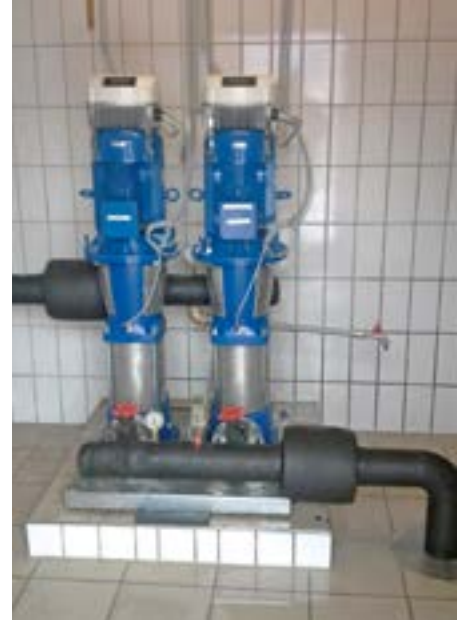
Druckstation Maurach neue Pumpen
